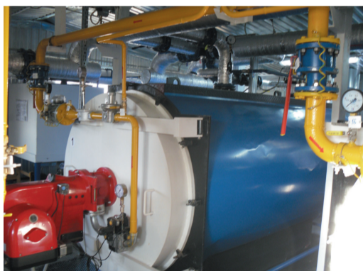
Оборудование котельной Бубновской КС
