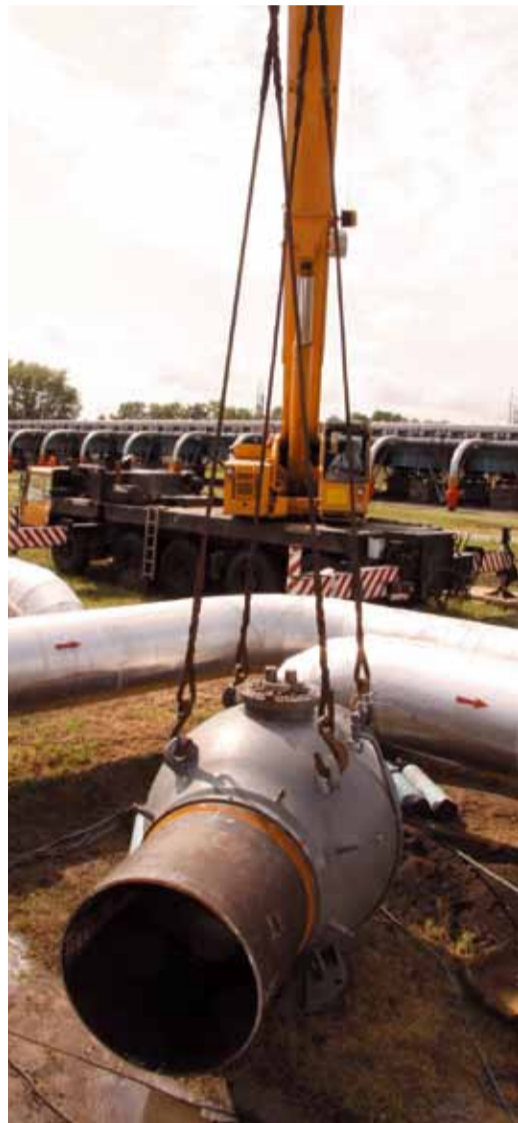
Этот запорный кран установлен на КС "Бубновка"
